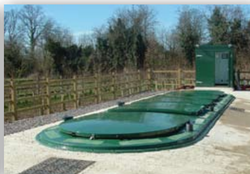
Station HiPAF Midi avec kiosque montré avec porte ouverte
