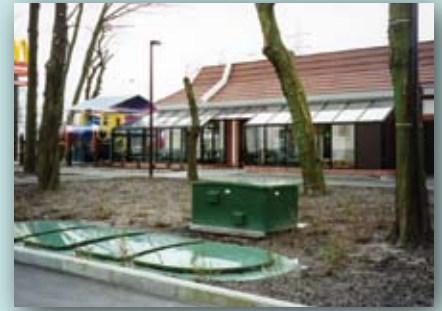
Station HiPAF Midi installée (ci-dessus) sur le site d'un établissement de restauration rapide à l'écart de la ville, Gent, Belgique
