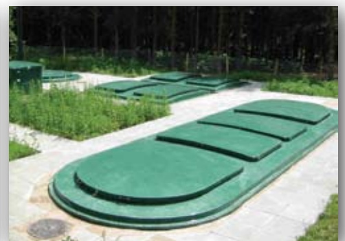
Station HiPAF Modulaire avec kiosque (en haut à gauche) et réservoirs primaire, biologique et secondaire séparés
